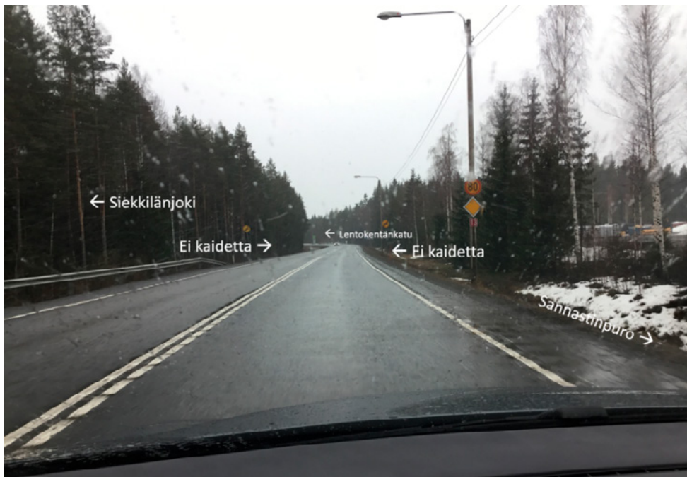
Kuva 67. Jyväskylälentien Lentokentänkadun liittymän ja Savilahdenkadun eritasoliittymän välillä ei ole kaiteita, vaikka tie sijaitsee penkereellä.
